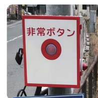
踏切非常ボタン
