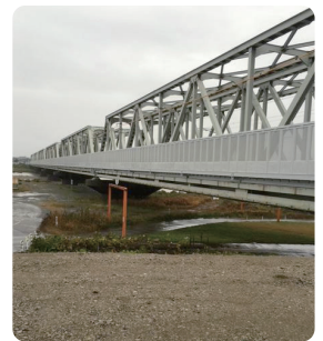
北陸本線 手取川橋りょうに設置した防風柵
