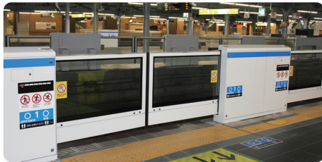
可動式ホーム柵 〔在来線7駅、新幹線6駅に設置〕
