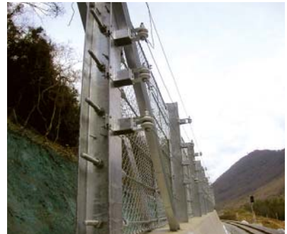
落石検知装置の設置
