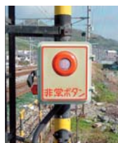
踏切非常ボタン
