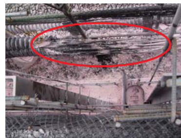
焼損した信号ケーブル
