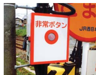
踏切支障報知装置
