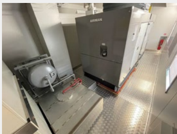
写真5: 検測用エンジン発電機
