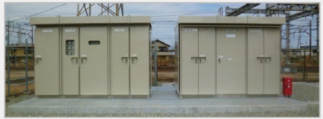
写真2：電力貯蔵装置(東海道線野洲き電区分所)
