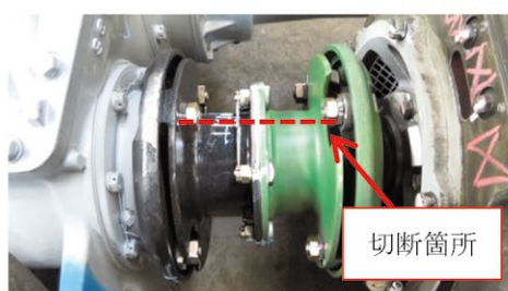
写真1：TD継手不具合時の切断箇所
