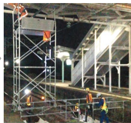
停電後に2段目・手摺を設置し点検実施 （並行して2線目ベース部を組立）
